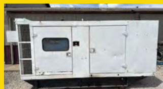
John Deere 6068H Triton Genset Shobonier, IL
