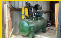
Ingersoll Rand 71T2- 10E2 Air Compressor
