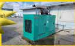
Onan 40KW Genset
