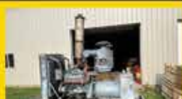
1996 Detroit Genset Leroy, MI
