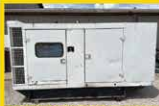
John Deere 6068H Triton Genset Shobonier, IL
