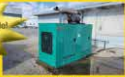
Onan 40KW Genset
